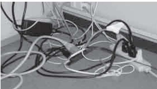
〈写真1〉スパゲティ状の電力ケーブル
