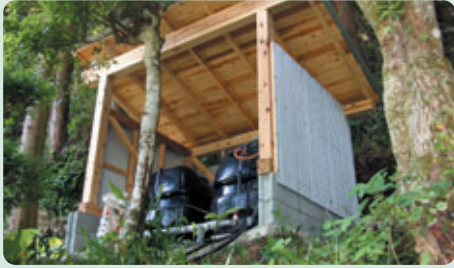
(a) 水圧を確保するため5.6m高い場所に設置した給水タンク
